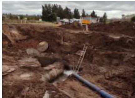
Figura 3. Zona de rotura 4LB – Campo Méndez
