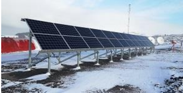
Fig. 4. Paneles solares fotovoltaicos instalados en la base
