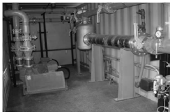
Foto 5: Sala de desgasificación
