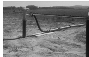
Foto 3: Cabezal de dren horizontal
