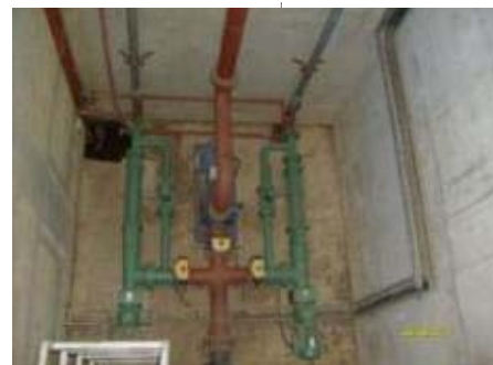
Figura 3- Bombeo al Filtro de Bandas.
