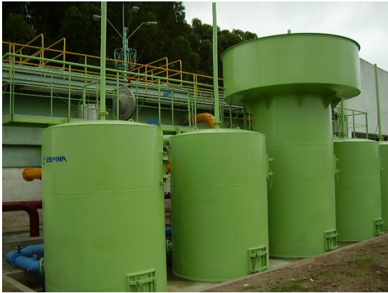
Figura 1.- Vista de filtros, UPA 2000 al fondo.
