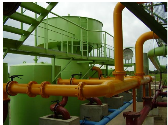
Figura 2.- Tuberías amarillas de ingreso de agua decantada a los filtros y tubería azul, de recolección de agua filtrada
